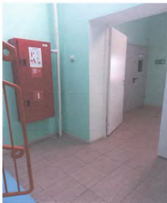
Фото № 20 – Пожарные щиты около лестниц
